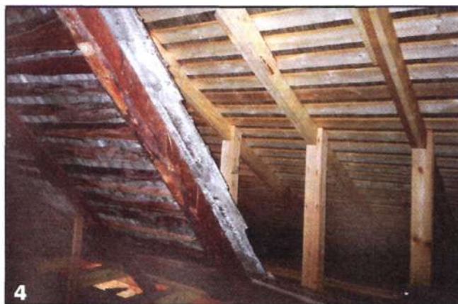
Треугольники жёсткости: балка — стропило — стойка надёжно связывают элементы старой и новой несущих конструкций.
